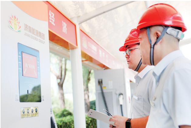
能源职工正在对奥体中心汽车充电站进行检查维护。
