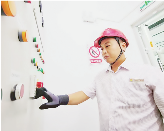
匡山片区自管站接管改造后,供暖管家调试换热站设备,为今冬采暖做好充足准备。
