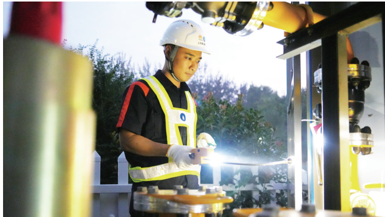
能源燃气工作人员正在对燃气调压箱内的设备进行安检。
